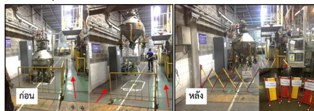
ภาพที่ 2 (a) ภาพก่อน , (b) ภาพหลังการปรับปรุง การวางแนวกันและติดป้ายห้าม
